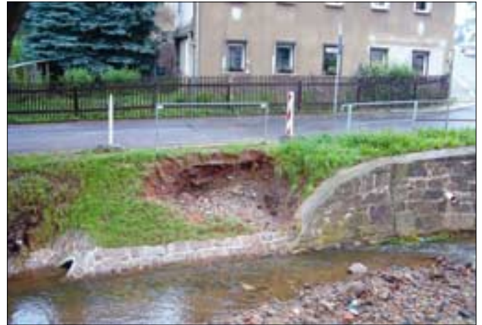
Ausspülung Uferweg Ecke Limbacher Straße
